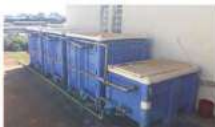
03 bồn chứa dung dịch (nước - phân, thuốc trừ sâu) cung cấp cho hệ thống tưới công nghệ Israel Tại Trung tâm
