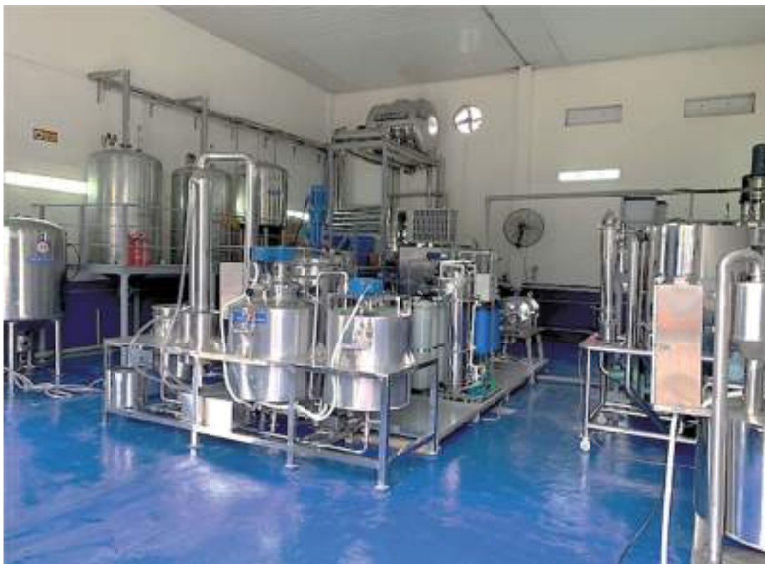
Hình 3. Hệ thống thiết bị sản xuất RMD công suất 50 kg nguyên liệu/mê
