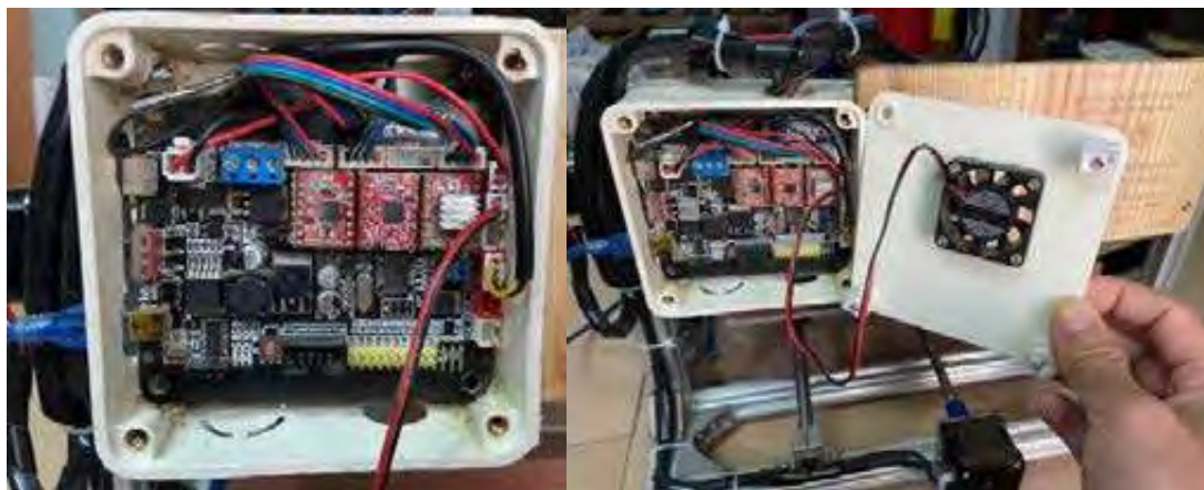
Hình 10. Hộp điện điều khiển máy CNC mini 3 trục
